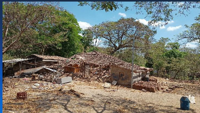
Vivienda de adobe colapsada
